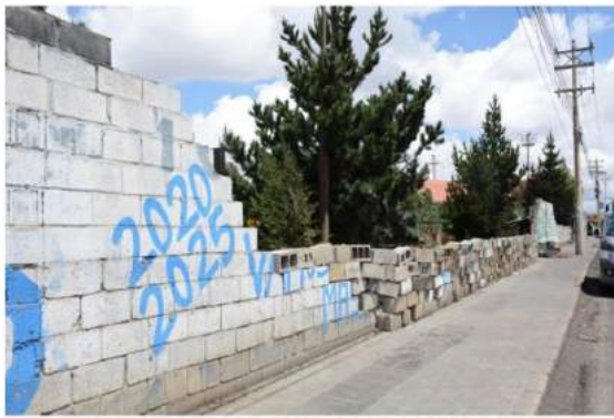
EXTERIORES DEL MURO DETERIORADO NO. 2 CORRESPONDIENTE A ÁREA DE TRABAJO NO. 1, UBICADO EN EL LADO ESTE DE LA PLANTA YPFB – SENKATA, EL ALTO, BOLIVIA
