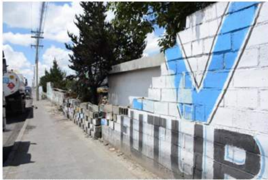
EXTERIORES DEL MURO DETERIORADO NO. 1 CORRESPONDIENTE A ÁREA DE TRABAJO NO. 1, UBICADO EN EL LADO ESTE DE LA PLANTA YPFB – SENKATA, EL ALTO, BOLIVIA
