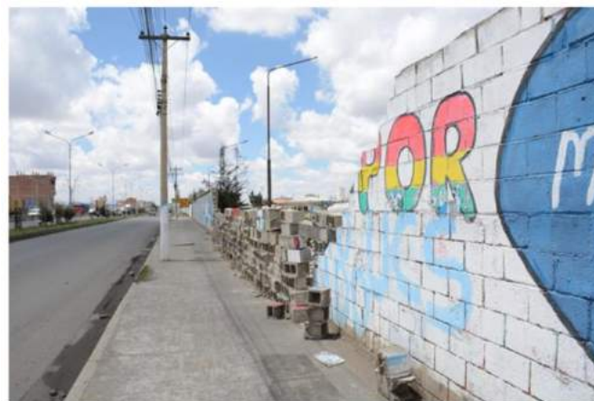
EXTERIORES DEL MURO DETERIORADO NO. 3 CORRESPONDIENTE A ÁREA DE TRABAJO NO. 1, UBICADO EN EL LADO ESTE DE LA PLANTA YPFB – SENKATA, EL ALTO, BOLIVIA
